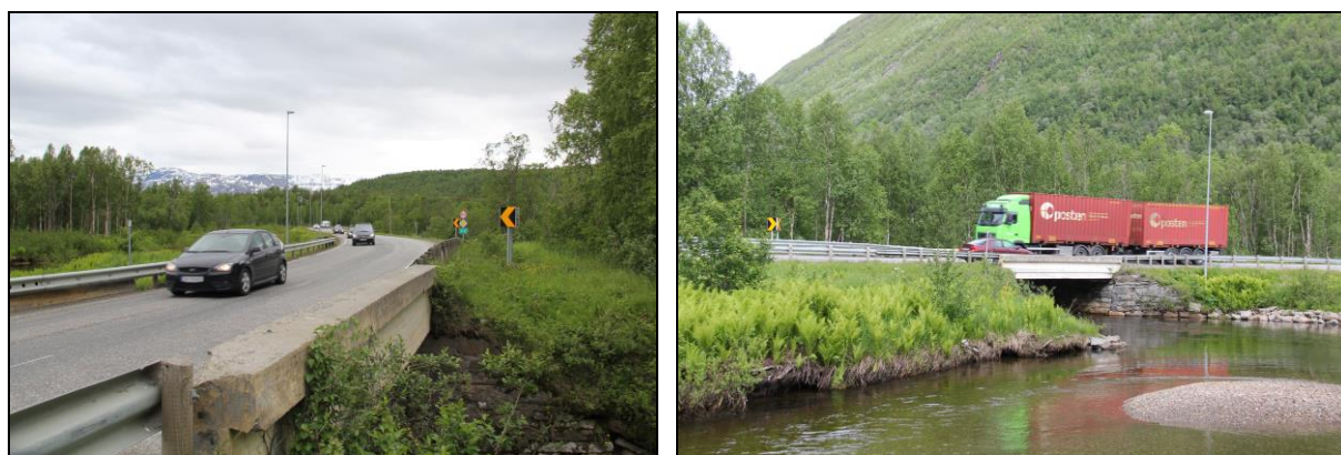
Figur 2. Høytverrelv bru på E6 er smal og tilfredsstillter ikke dagens krav til stamveg.
